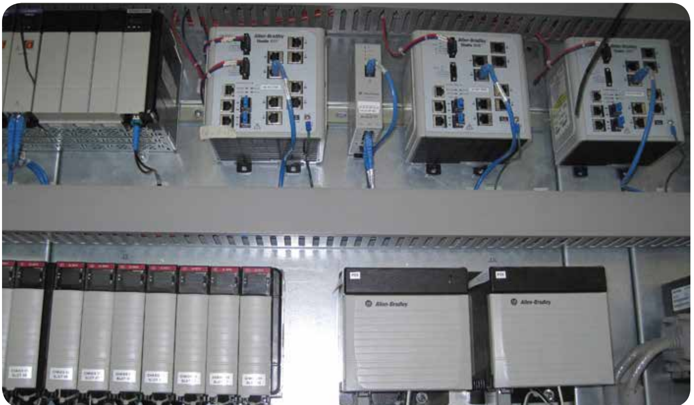
Uno de los controladores redundantes con 2 procesadores cada uno
