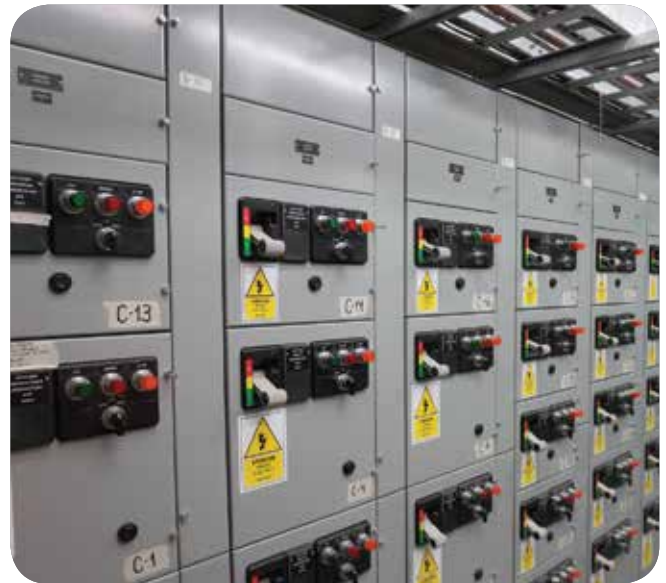
Vista parcial del MCC integrado con PlantPax.
